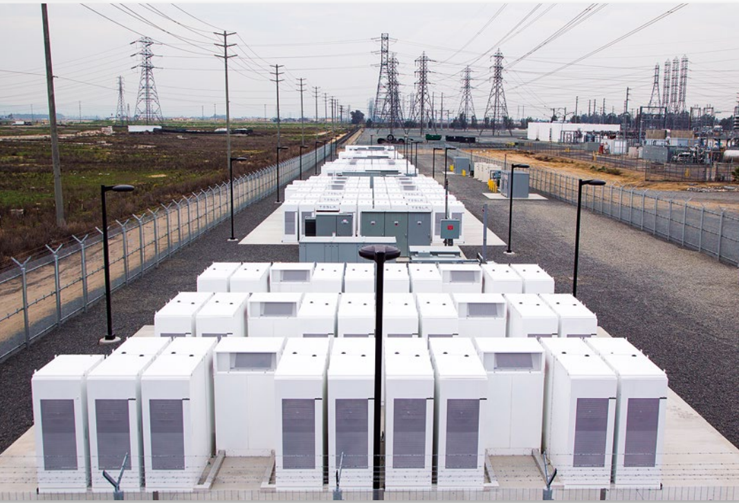
A la izquierda instalación con baterías ion-litio en Ontario, capaz de almacenar hasta 80 MWh y destinada a suministrar energía a Los Ángeles.
