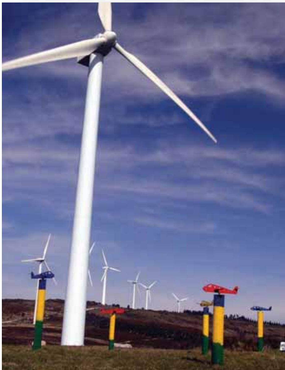
Parque eólico experimental de Sotavento.
