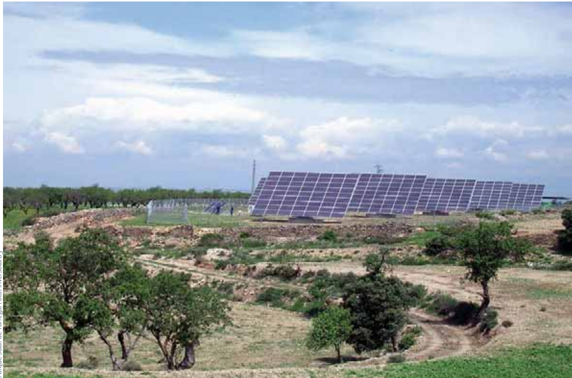
Parque solar de Tárraga. Foto: Inversolar6
