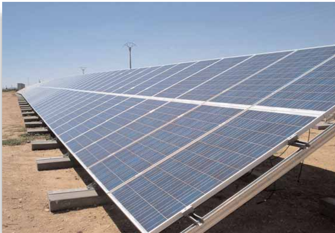
A la izquierda, paneles de la instalación Villa II en Villa de Don Fadrique (Toledo) y en la página siguiente, foto de los vecinos del pueblo palentino de La Serna, delante de su parque solar.
