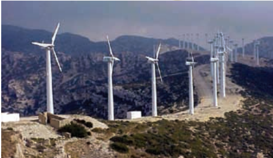
El parque eólico del Baix Ebre, situado en el Monte de Buinaca (Tarragona)
