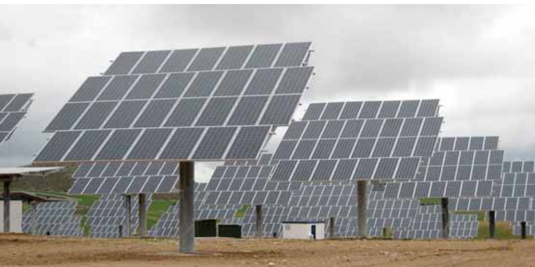
El parque de la Junquera, en el municipio murciano de Caravaca de la Cruz, tiene 1,5 MW de potencia. Sus 9.000 módulos fotovoltaicos se asientan sobre 300 seguidores solares de dos ejes. Puede abastecer las necesidades eléctricas de 970 familias.
