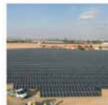
Planta Fotovoltaica en Murcia
