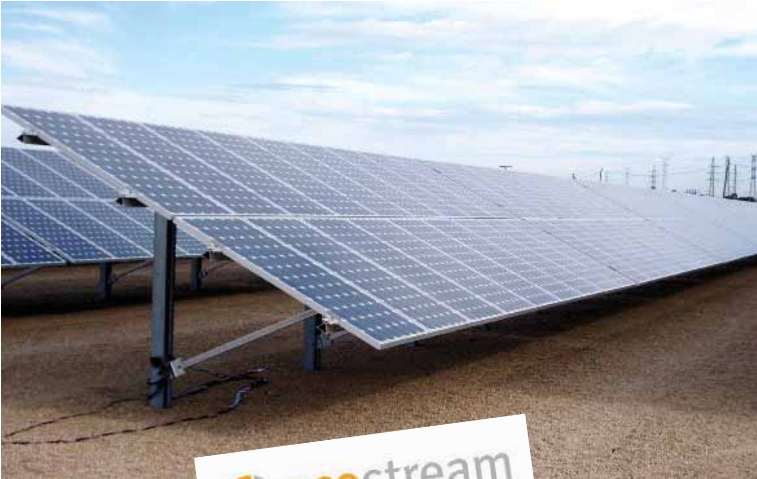
Ecostream tiene ya en su haber más de 4.000 instalaciones solares en toda Europa. En la foto, planta solar en Murcia.
