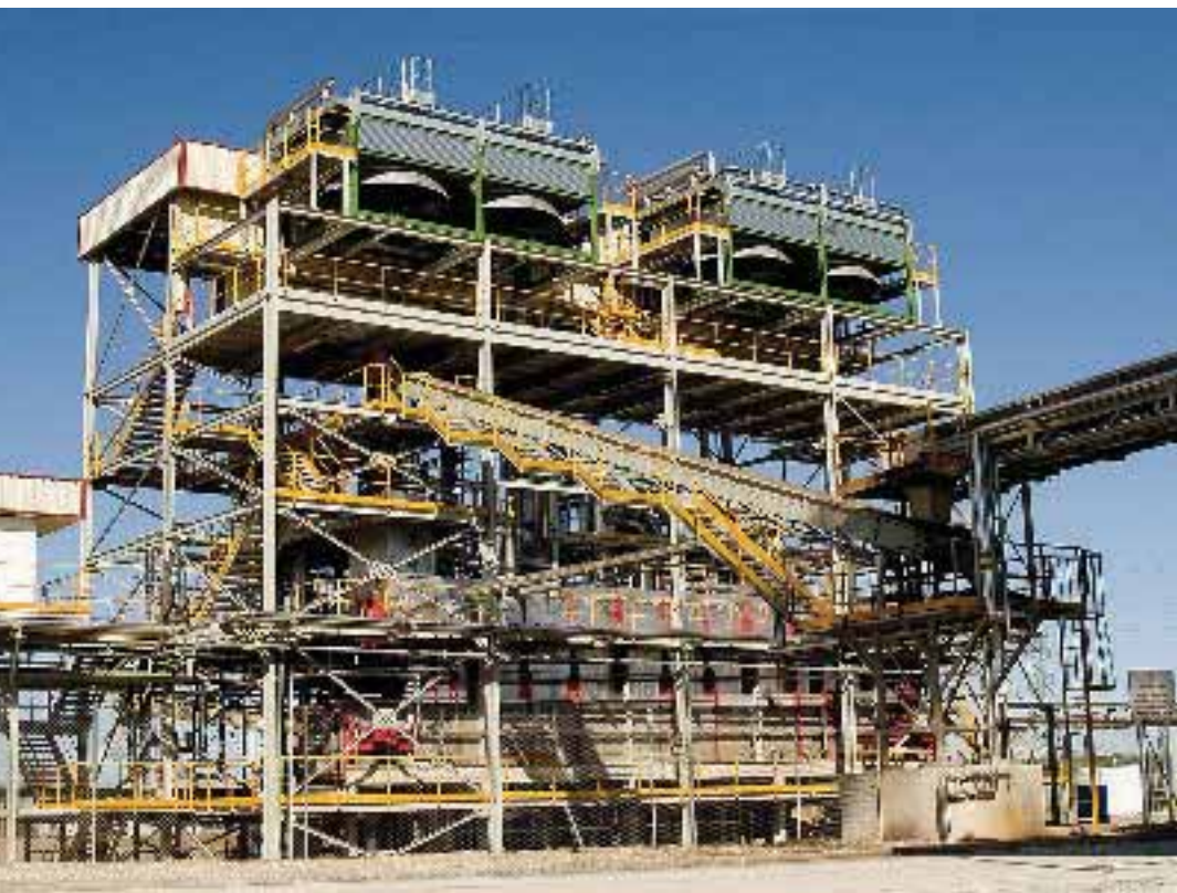
Abajo, planta extractora, capaz de procesar 150.000 toneladas de orujo al año, de las que extraerá 52.000 toneladas de orujillo, el combustible que utiliza la caldera de biomasa, a la derecha.
