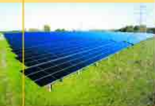
Instalación solar en la zona de Bielefeld, Alemania
