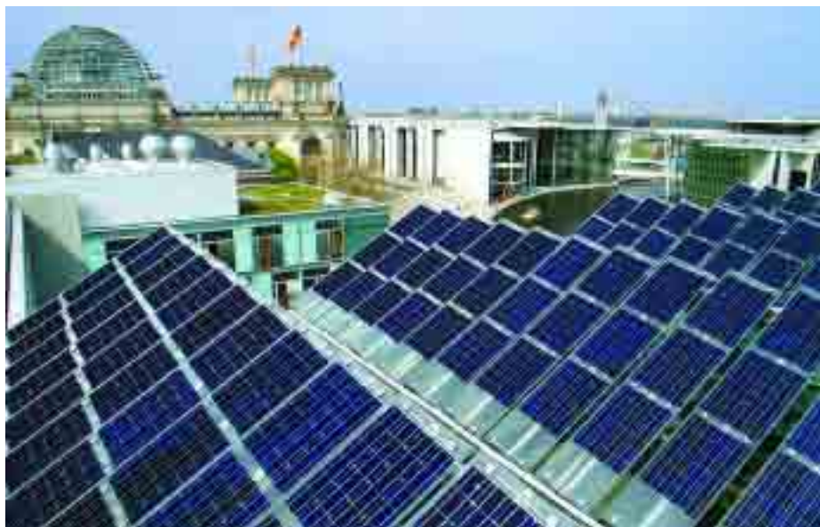
Instalación fotovoltaica en el barrio gubernamental de Berlín
