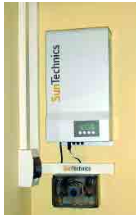
Los 28 módulos FV proporcionan una potencia instalada de 5,88 kW, equivalente a 7.300 kWh al año.
