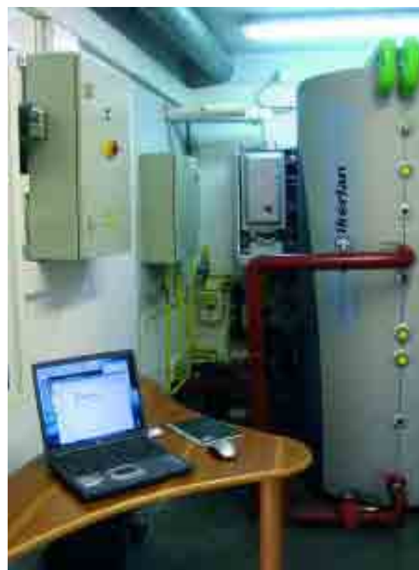
La producción de energía de los diferentes elementos que forman la instalación son gestionados y controlados mediante un equipo informático
