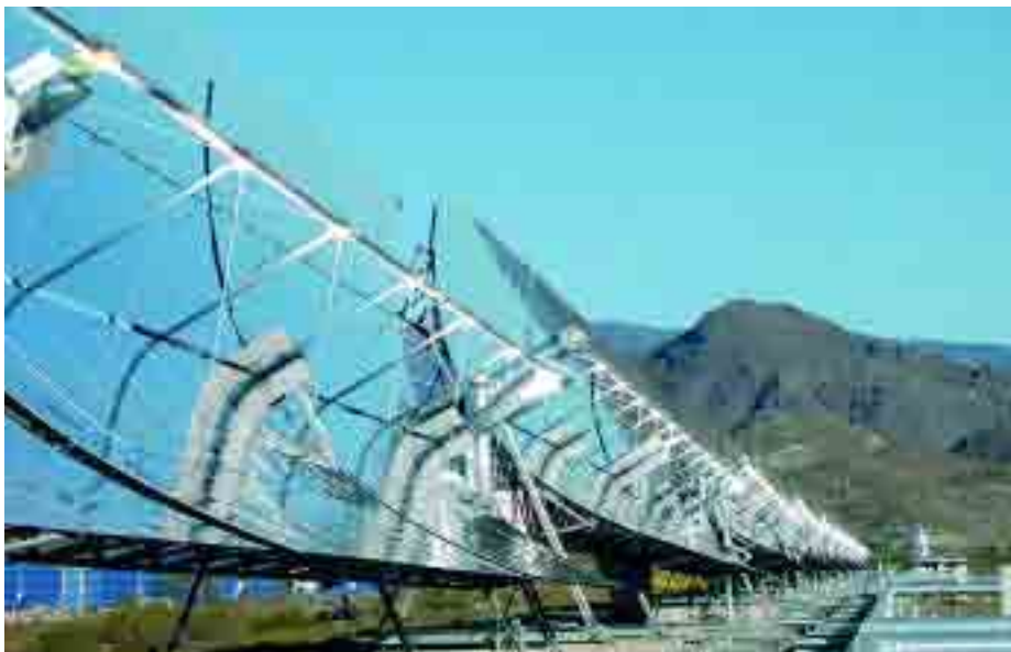
Visión parcial de una planta híbrida sol-gas con colectores cilindro-parabólicos y gas natural, en Kramer-Junction (California, USA).
