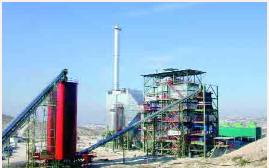
Planta de Standardkessel en Baena (Jaén). Como combustible, utiliza alperujo (residuo procedente de la obtención del aceite de oliva)
